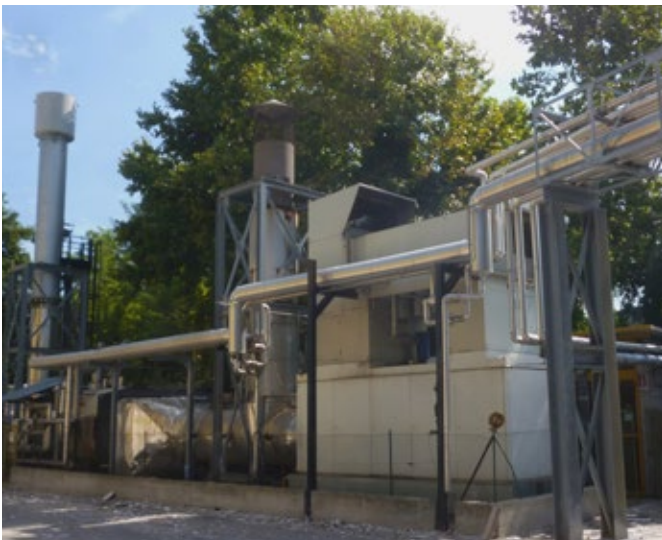
Cartiera Carval S.r.l. - Brescia, Italie Centrale de cogénération: 1 MWe & 2,25MWt
